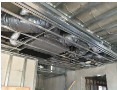
天井内エアコン
